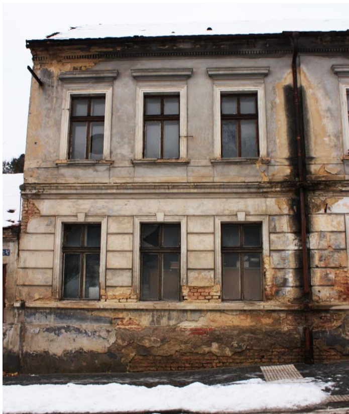
Obr. 4 Příklad znehodnocení stavby v důsledku působení cyklických zatěžovacích účinků a vlivů především teploty, vlhkosti a zanedbání péče (Praha – Libeň, v současné době již zbouráno, foto K. Kroftová)
