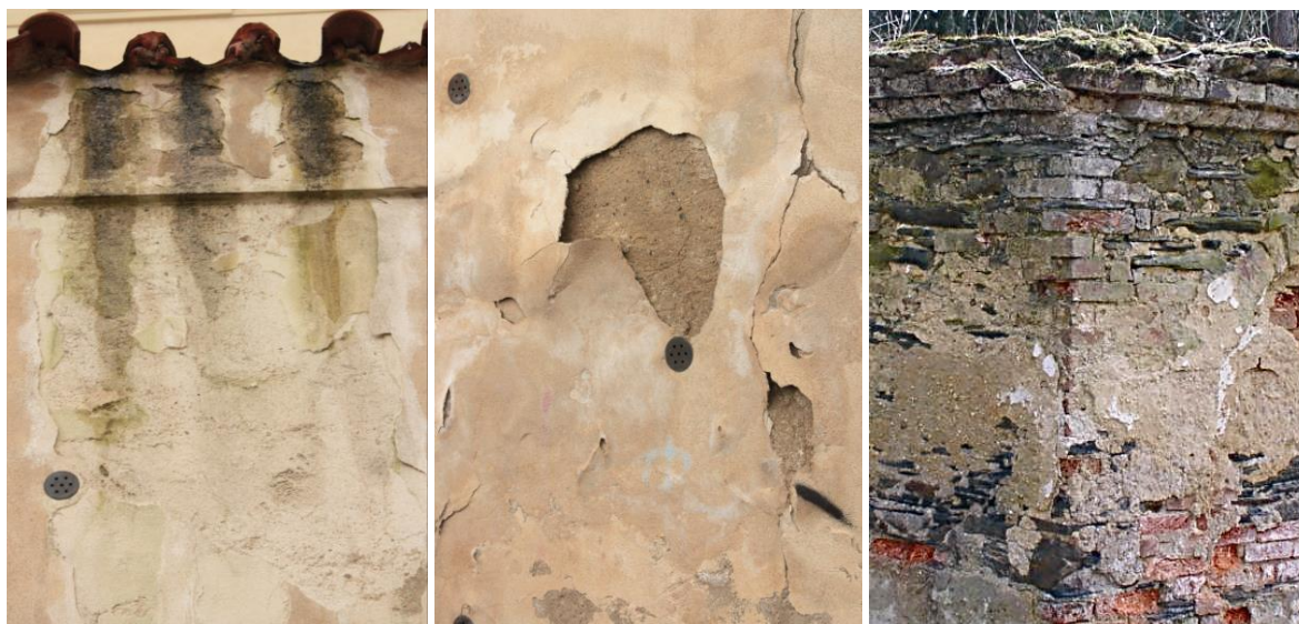
Obr. 16 Příklady narušených povrchů vnějších omítek vyvolané zvýšenou vlhkostí a s tím spojenými chemickými, fyzikálními a mikrobiologickými degradačními procesy (Foto K. Kroftová, T. Čejka)
