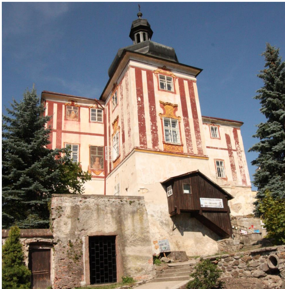
Obr. 14 Poškození povrchových úprav významným způsobem negativně ovlivňuje nejen stav stavebních konstrukcí, ale také výraz historické stavby. Omítané povrchy zámku v Kácově jsou charakteristické celkovým rozpadem, odlupováním povrchových vrstev a odpadáváním od podkladu, vytvářením boulí, výskytem trhlin i ztrátou, resp. změnou barevnosti povrchových úprav (1. polovina 18. století, foto K. Kroftová)
