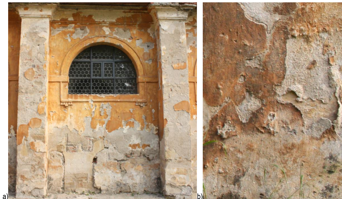
Obr. 22 Příklad degradace omítkového líce a následný rozpad přívrchových vrstev způsobený synergickým negativním působením degradačních faktorů: a) pohled na výsek obvodového zdiva; b) detail degradovaného povrchu s patrným rozvrstvováním a rozpadem povrchových vrstev, barevnými změnami a mikrobiologickým napadením (kostel Nanebevzetí Panny Marie, Plasy, foto K. Kroftová)
