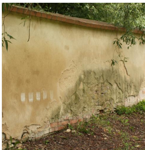
Obr. 136 Omítaná kamenná zeď s degradovanou omítkou (Pozn. Červenou čárkovanou čarou je označeno místo aplikace nanosuspenzí)
