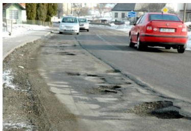
Obr. 1.14 Výtluky na silnici nutí řidiče k jízdě ve středu komunikace. To může vést k nebezpečným konfliktním situacím (zdroj: www.boskovice.cz ).
