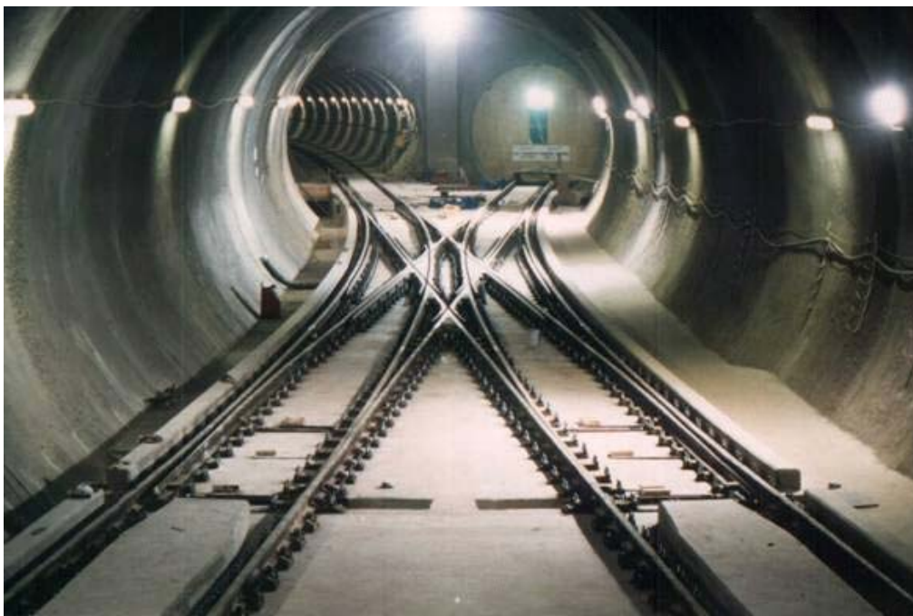
Obr.3 Komora křížení tunelu HEX s definitivním ostěním ze stříkaného drátkobetonu
