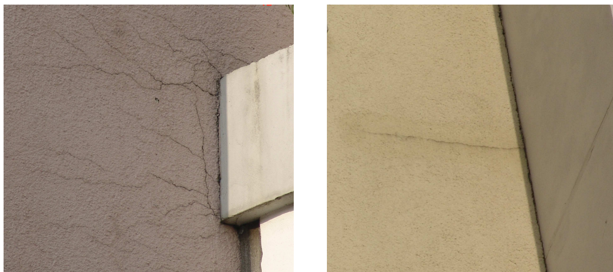
Obr. 3: Poruchy tenkovrstvé omítky kontaktního zateplení fasád panelových domů, Německo, Weimar – síť strukturních trhlin (a) a jednotlivé trhliny (b)
