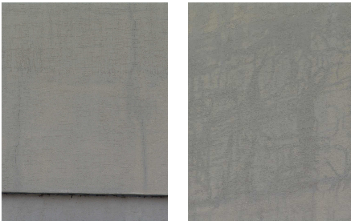
Obr. 2: Dva specifické příklady poruch v tenkovrstvé omítce kontaktního zateplení obvodových plášťů panelových domů v české republice – jednotlivé osamocené trhliny (a) a síť strukturních trhlin v ploše fasády (b)
