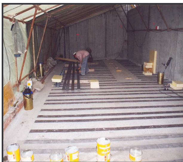
Obr. 39 Zesílení stropní desky plochou ocelí, jednalo se o náhradu neuložené výztuže při provádění stropní desky.
