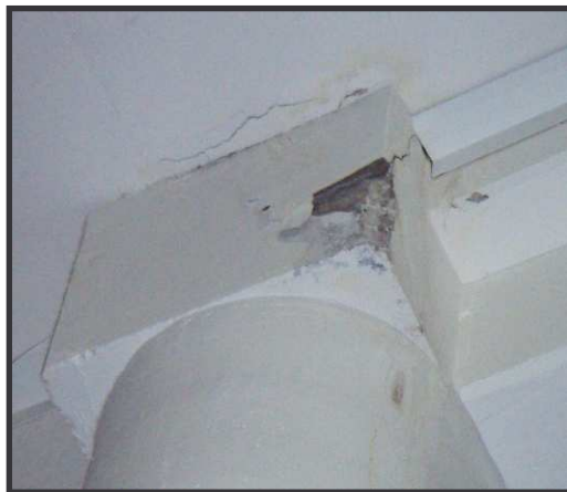
Obr. 5 Pohled na korozivní porušení krycí vrstvy betonu.
