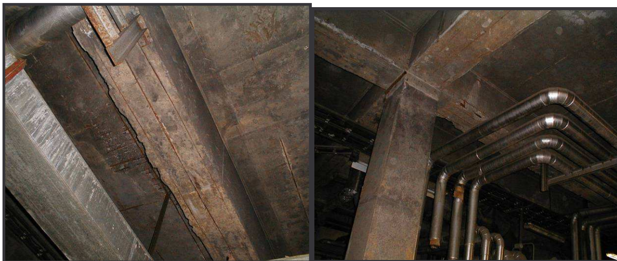
Obr. 32 a 33 Pohled na spodní líc desky, který byl jediný volný pro možné umístění zesilující konstrukce, investor neumožnil změnu dispozice v přízemí, použití nových např. ocelových podpůrných sloupů a trámů.
