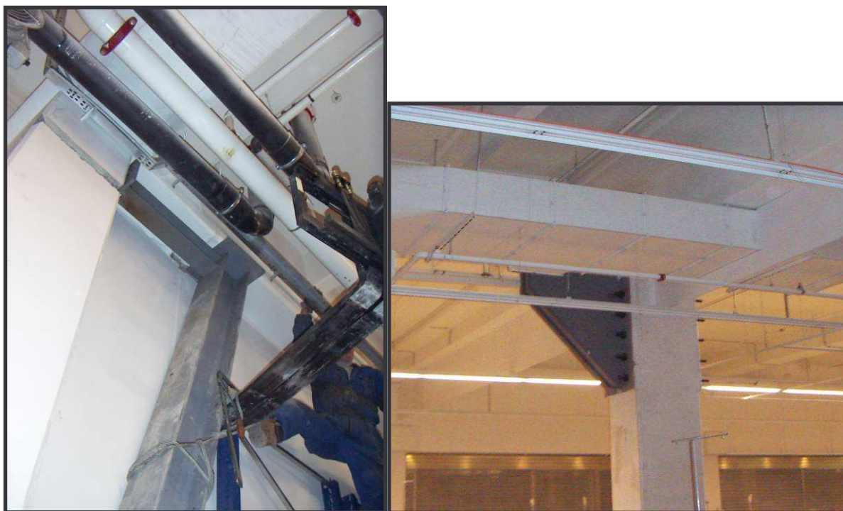
Obr. 25 a 26 Zobrazuje navržené podepření konstrukce, v místě skladů šikmou vzpěrou v obchodních prostorech pak pomocí ocelového krakorce. Ocelová konstrukce byla dodatečně opatřena obkladem z protipožárních sádkartonových desek.
