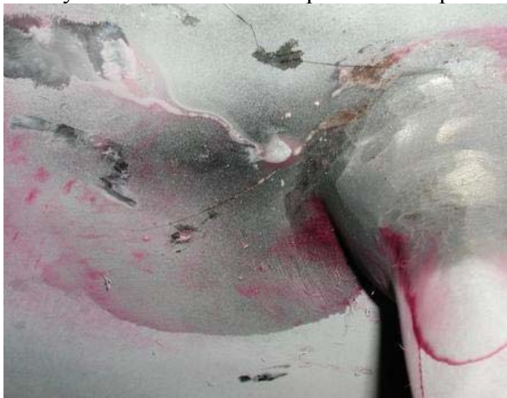
Obr.16. Detail prasklinek v místě nátrubku odvodnění
