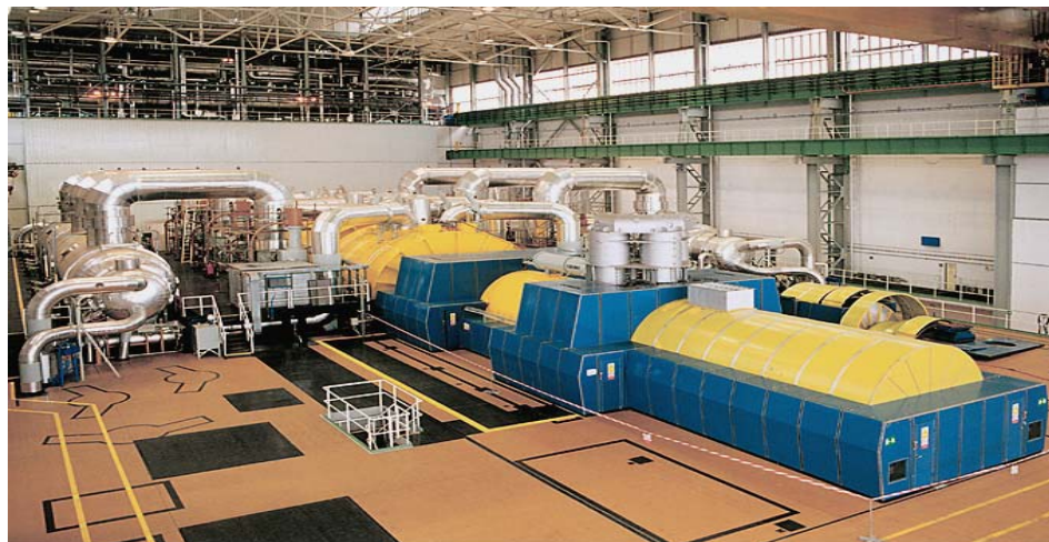
Obr.13. Smontovaný turbogenerátor – pohled od generátoru
