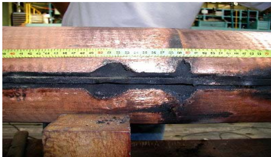
Obr.14. Detail mezipólového zkratu budících přívodů
