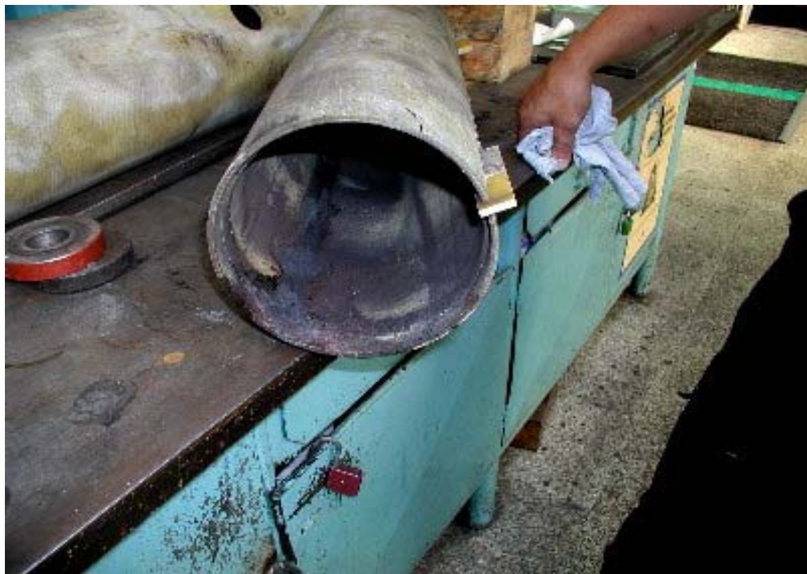
Obr.15. Sklotextitová isolační trubka se stopami spalín po zkratu
